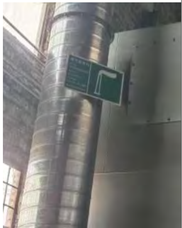
废气排放口标志牌
