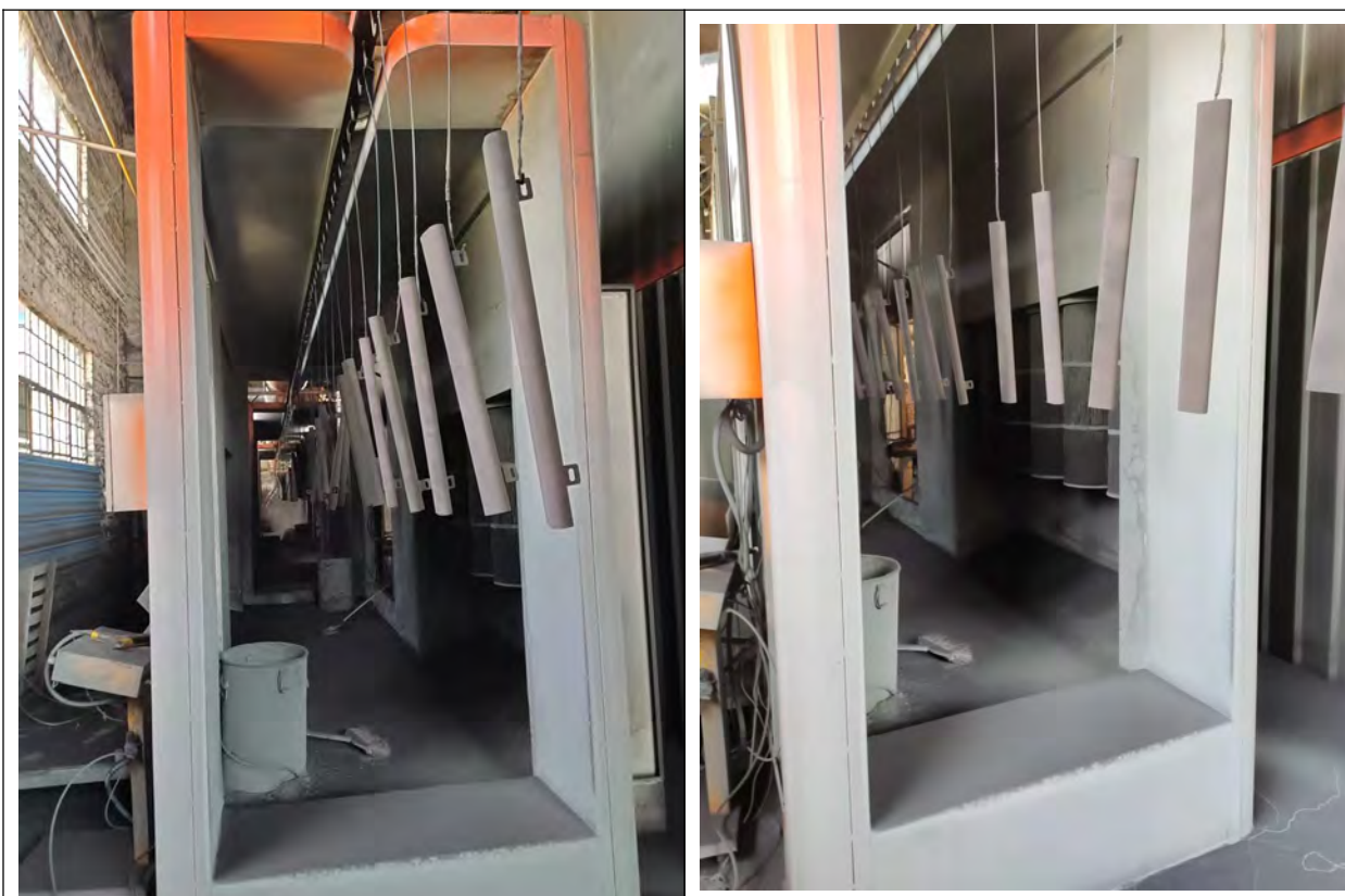
喷粉柜配套滤芯除尘装置
